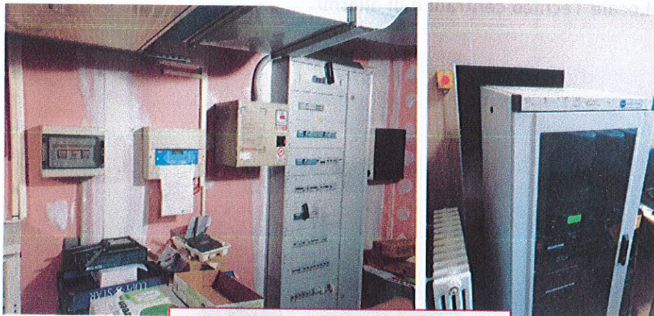
Centralina impianto rilevazione incendi ed EVAC
